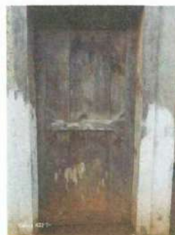
Foto 2: Puerta deteriorado por humedad
