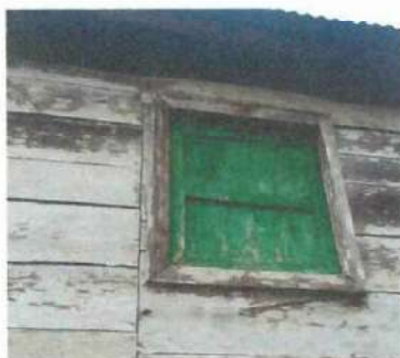
Foto 3: Ventana posteior de escuela con deterioro.
